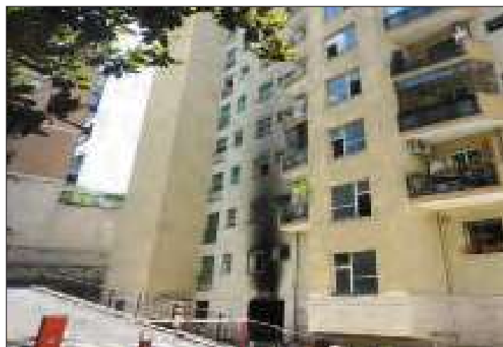
Incendio autorimessa condominiale
