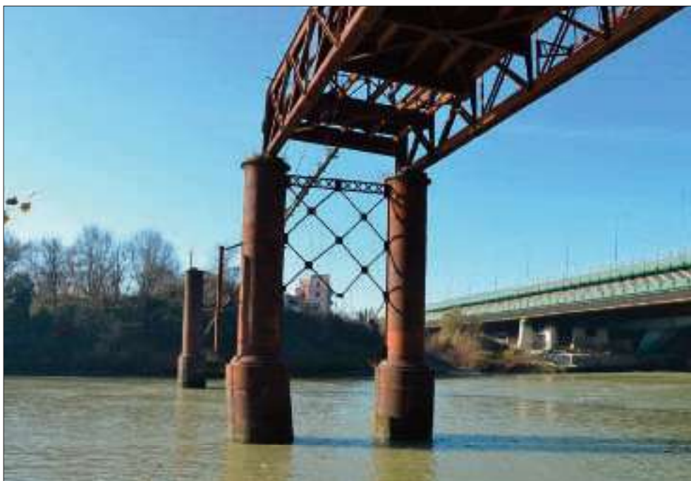
Ponte di Castel Giubileo, resti visti dalla riva sinistra
