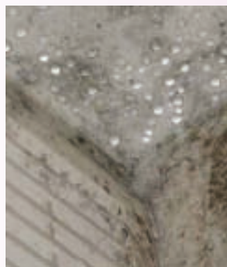
Esempio di condensa superficiale
